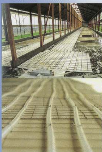
床面暖房システム
